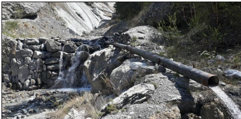
Prise d'eau en rive gauche du Saint-Antoine Source : AMETEN
