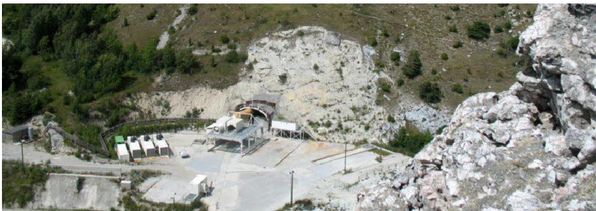
Entrée de la descenderie de Villarodin-Bourget/Modane, à environ 1,5 km au nord-est de l'aire d'étude Source : www.telt.eu
