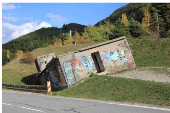
Maison penchée Source : ATDx
