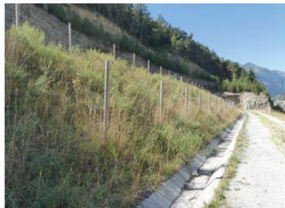
Vue 15 : structuration des talus enherbés en aval de la falaise
